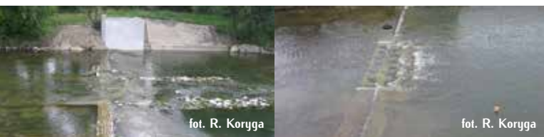
Udrożnione bariery migracyjne w Pleśnej (po lewej) i Ciężkowicach (po prawej).
